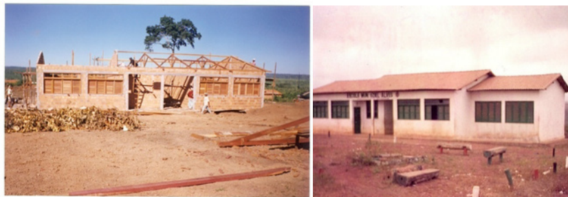
Figura 3 - O prédio da Escola Municipal sendo construído pela Prefeitura de Açailândia em 1998.
