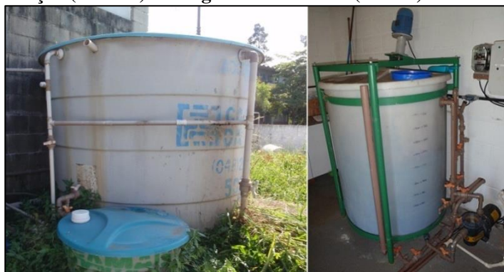
Figura 5 – Reservatórios de efluente bruto do sistema experimental: tanque externo de 5.000 L (esquerda) e tanque interno de equalização (1.000 L) com agitador mecânico (direita).
