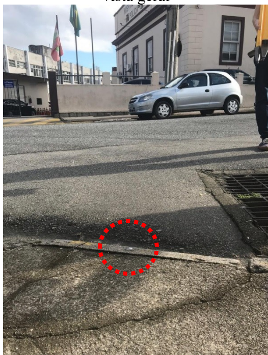
Figura 6 - Ponto Hospital – Pino engastado – vista geral
