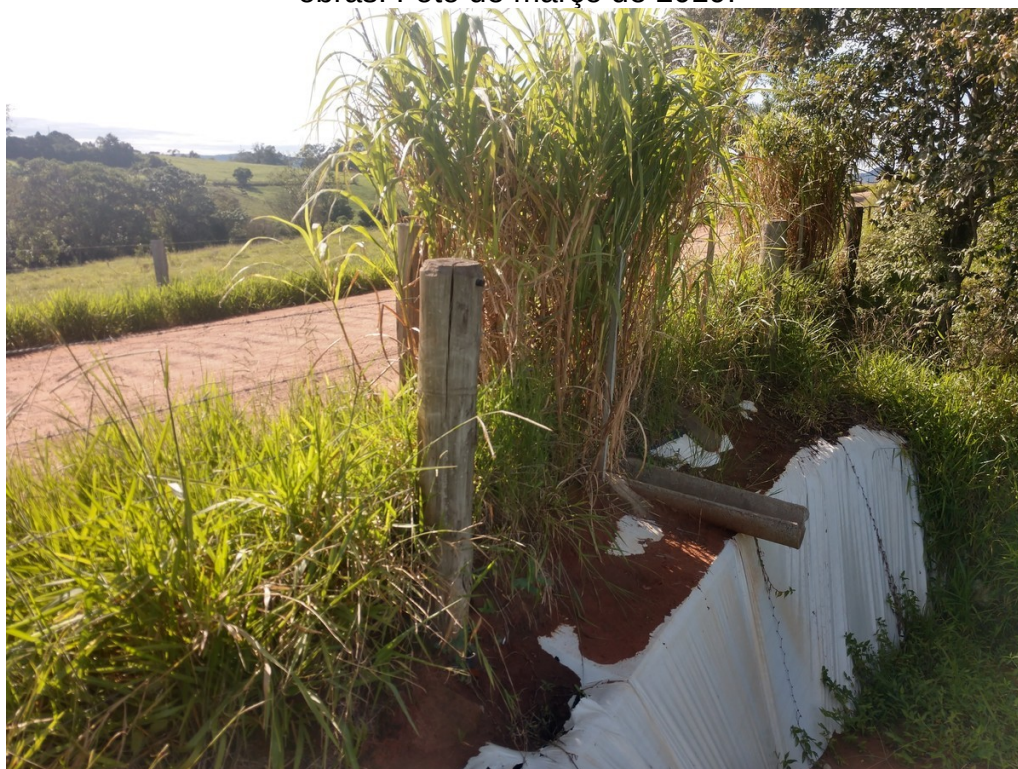
Figura 147 – Técnica: coletor de água e areia que escoa da rua e a ser utilizada em obras. Foto de março de 2019.
