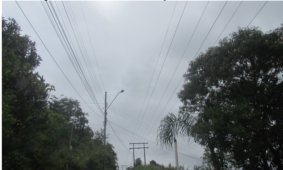
Figura 21 – Fotografia; Linha de transmissão que atravessa a TI Morro dos Cavalos
