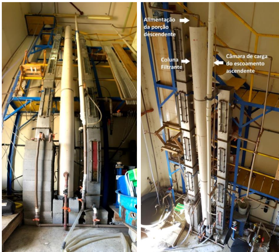
Figura 5 e 6 – Filtro bifluxo alocado na Sala de Pilotos da ETA Lagoa do Peri.
