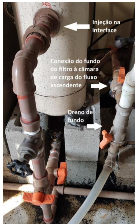
Figura 13 - Imagem do filtro piloto que demonstra a drenagem de fundo, injeção na interface e suas válvulas de controle.
