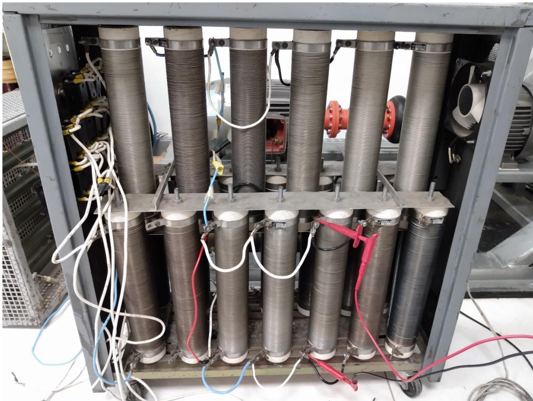
Figura 26. Foto da carga resistiva trifásica em estrela utilizada na implementação da bancada de emulação eólica.
