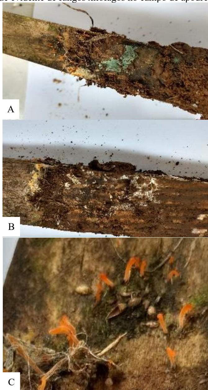
Legenda: (A) fungos emboloradores (B) fungos apodrecedores e (C) estruturas de colonização. Fonte: Nunes, 2018.
