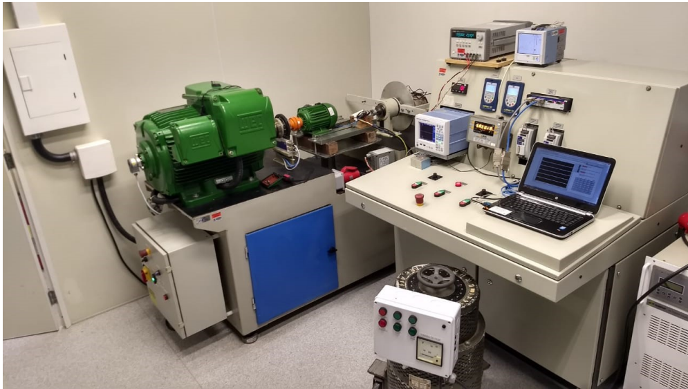
Figura 1 – Bancada de ensaios de Motores de Indução Trifásicos.
