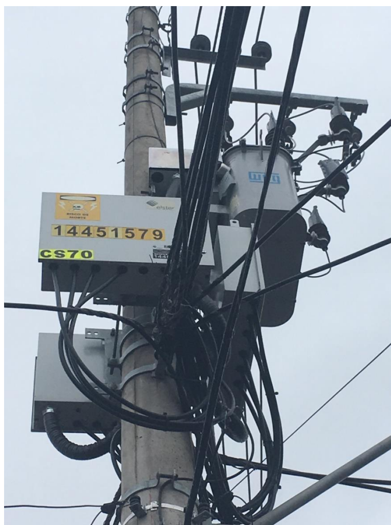
Figura 5 - Caixa Concentradora Secundária em Mogi das Cruzes - SP
