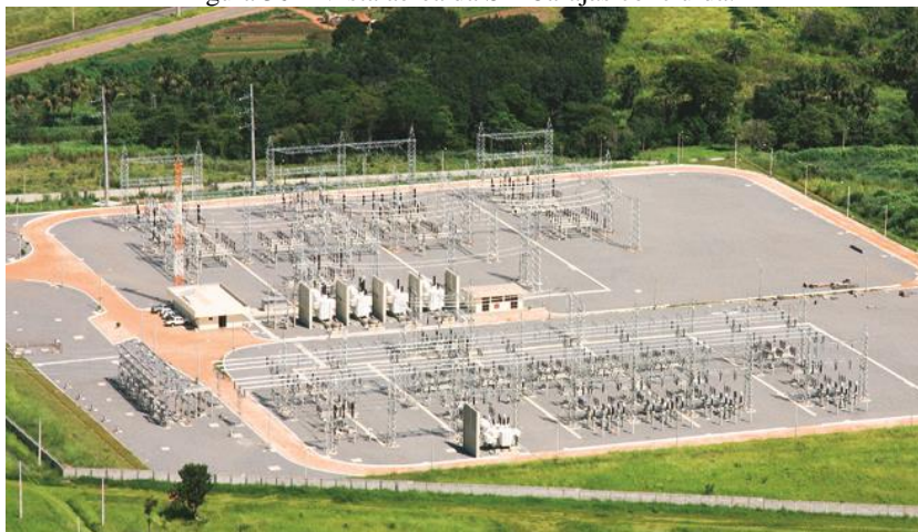
Figura 36 – Vista aérea da SE-Carajás concluída.
