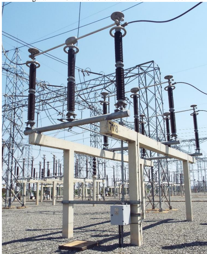
Figura 24 – Chave Seccionadora 230 kV – in loco.
