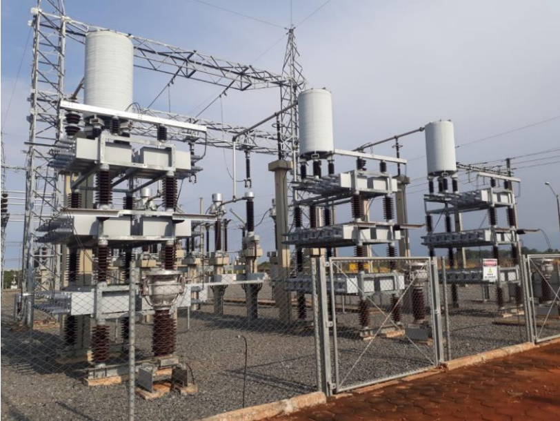
Figura 26 – Banco de Capacitores – in loco.
