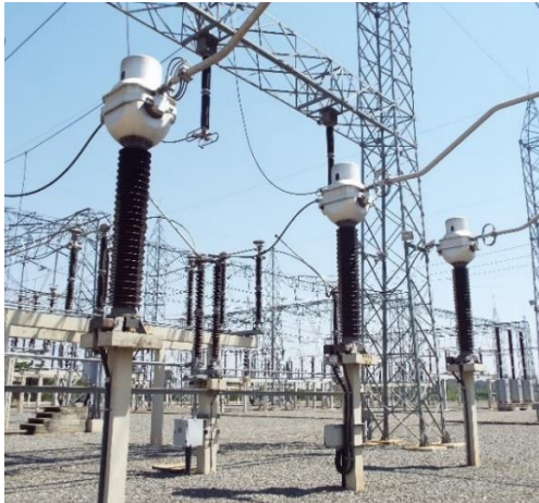
Figura 21 – Transformador de Corrente 230 kV – in loco.
