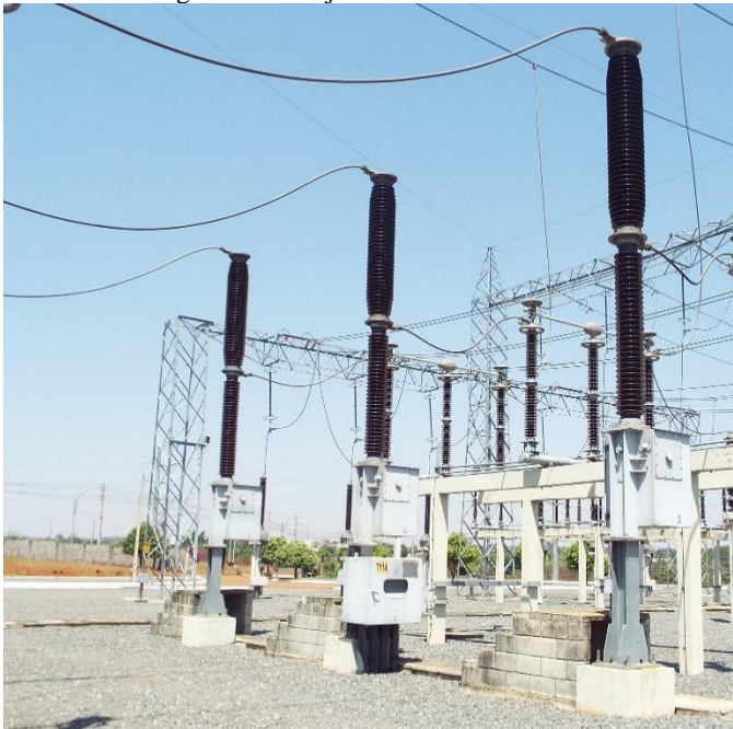
Figura 23 – Disjuntor 230 kV – in loco.
