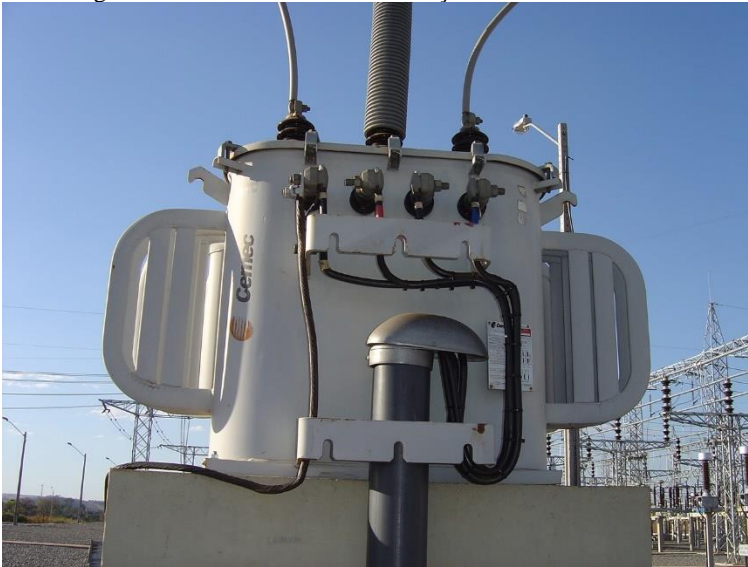
Figura 20 – Transformador de Serviços Auxiliares – in loco.
