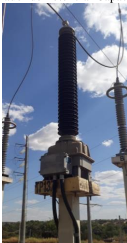
Figura 22 – Transformador de Potencial Capacitivo 230 kV – in loco.
