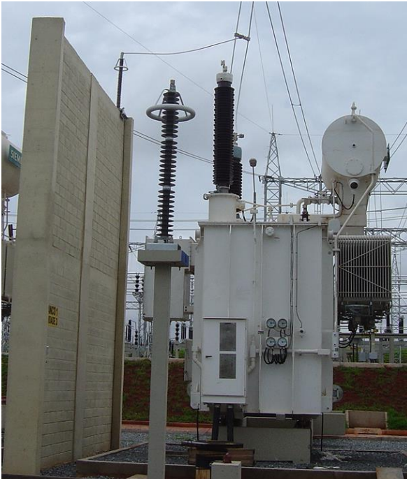
Figura 18 – Autotransformador de Potência 230/138 kV – in loco.
