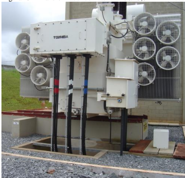
Figura 19 – Transformador de Potência 138/13,8 kV – in loco.
