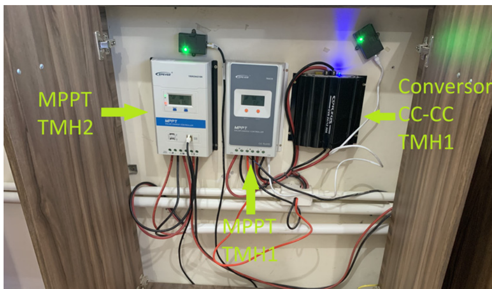
Figura 34 – Controladores MPPT da TMH1 e da TMH2.
