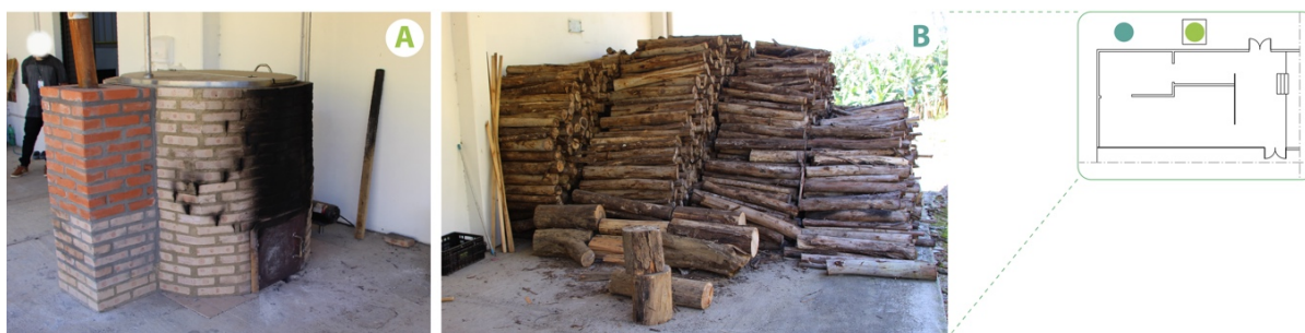
Figura 37: boiler (A) e toras de madeira (B) utilizadas para aquecê-lo.
