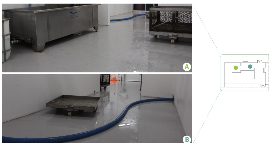
Figura 50: acúmulo de água no ambiente.
