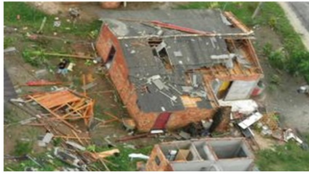
Casa destruída após o furacão Catarina, 2004.
