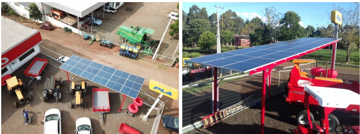
Figura 14 – Vista do local de instalação dos módulos fotovoltaicos na Unidade Y.
