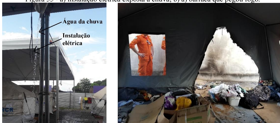
Figura 55 - a) instalação elétrica exposta à chuva; b) barraca que pegou fogo.
