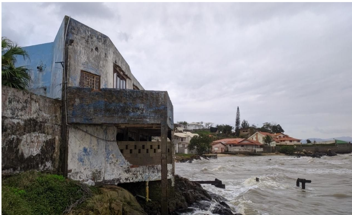
Figura 28 - Edificação irregular junto à Praia da Guararema
