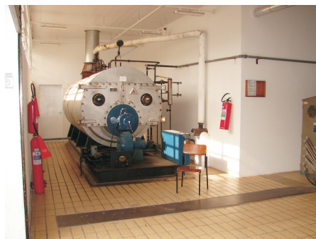
Caldeira elétrica Fonte: Arquivo pessoal
