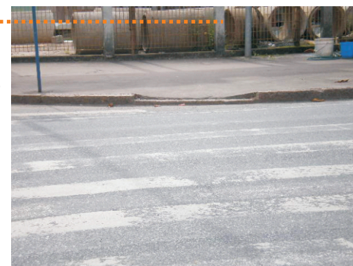
Passeios sem rebaixamento (ou com rebaixamento muito precário) e sem sinalização tátil para travessia.
