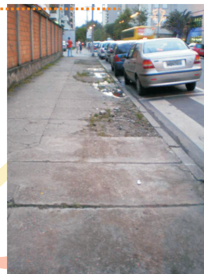
Passeios irregulares, e sem piso guia e piso alerta.
