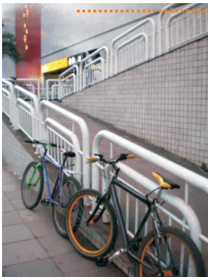
Rampas com inclinação inadequada.
