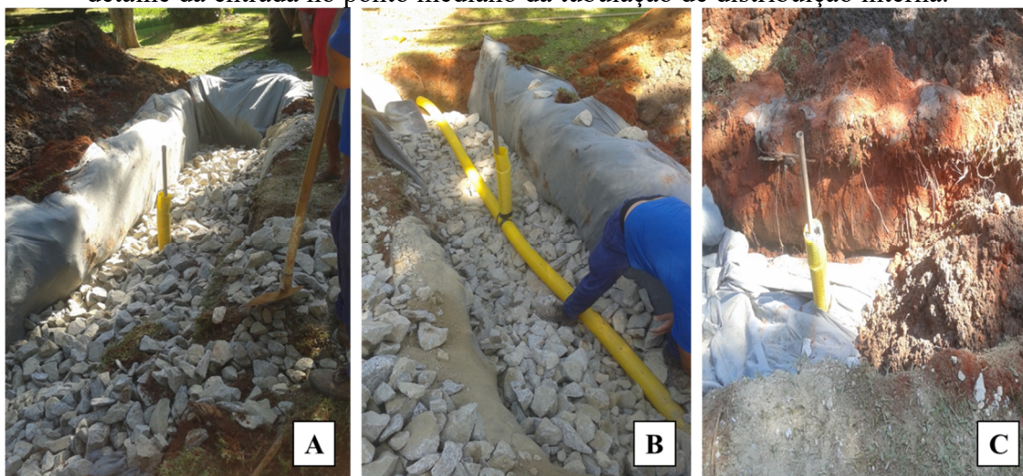
Figura 15 – Detalhes construtivos da vala de infiltração. a) vala de filtração com o meio suporte e tubulação posicionada; b) detalhe da tubulação interna de distribuição; c) detalhe da entrada no ponto mediano da tubulação de distribuição interna.
