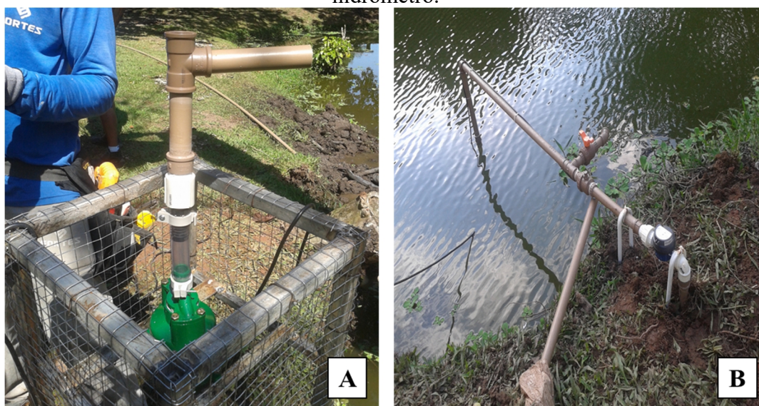
Figura 14 – Detalhes dos sistema de captação de água do lago estudado. a) conjunto moto-bomba; b) cavalete de entrada com extravasor, registro de controle da vazão e hidrômetro.
