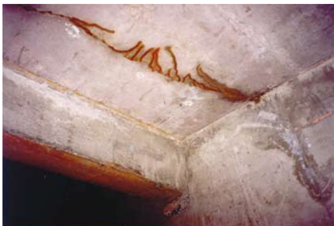
Figura 21 – Problemas na estrutura de concreto provocados por infiltrações
