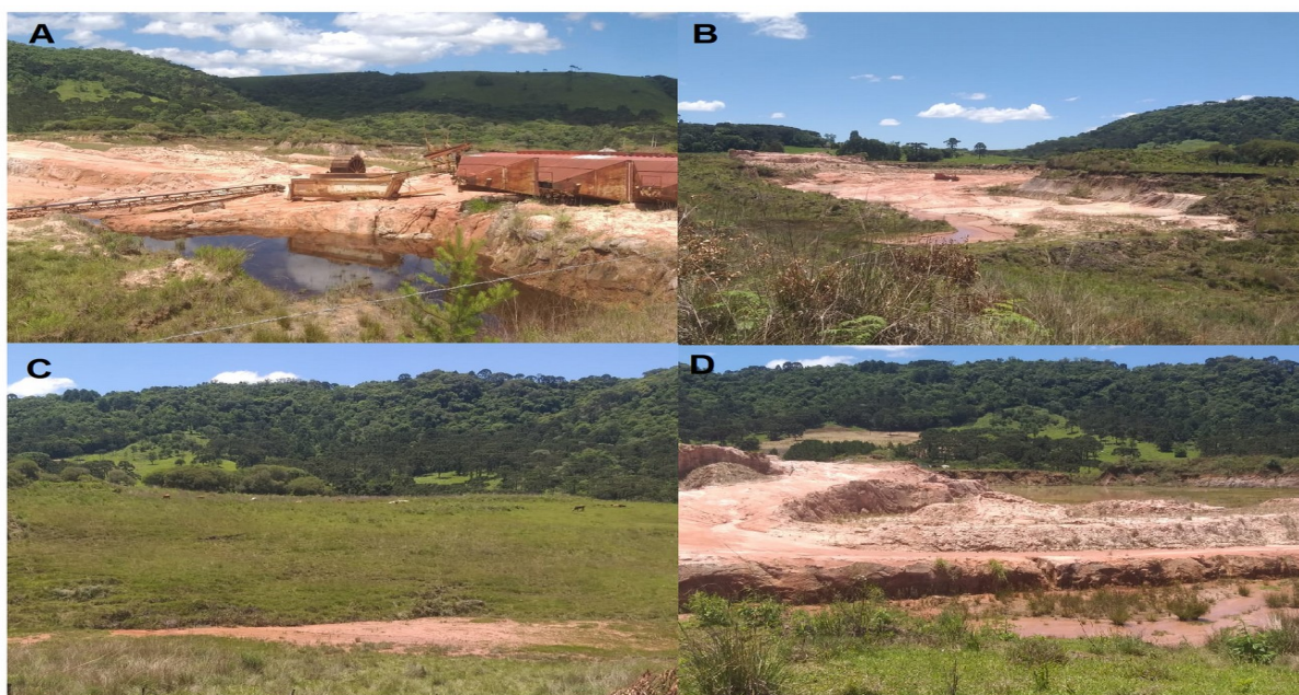
Figura 16: Passivo ambiental deixado por empresa após exploração de areia em Ponte Alta – SC.
