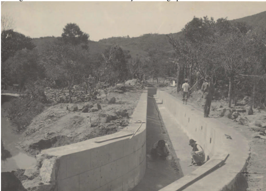
Figura 13: Aterro de Várzea e canalização de córrego perto do Morro do Antão.
