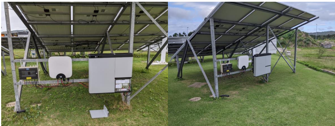
Figura 2. Sistema de armazenamento instalado no laboratório Fotovoltaica-UFSC (stringbox + inversor FV + bateria). Fonte: elaborado pelos autores.
