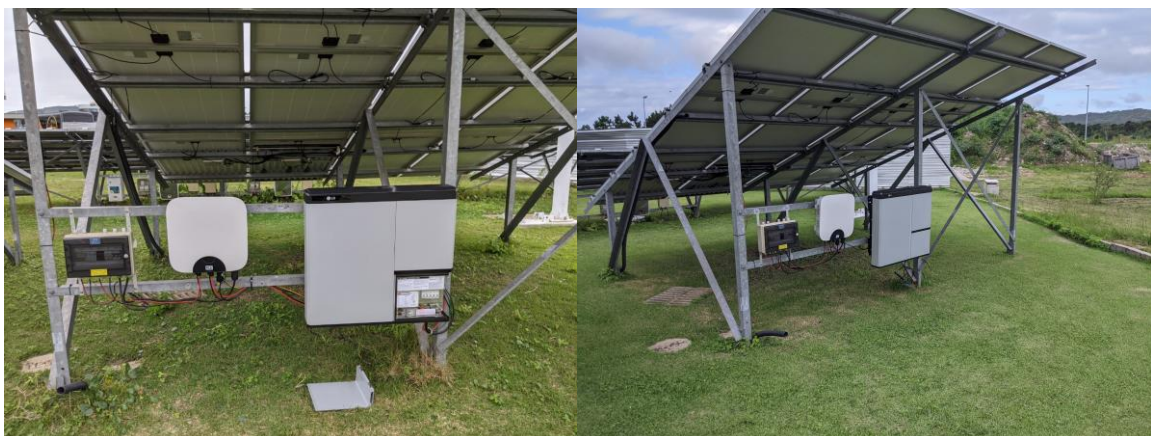
Figura 2. Sistema de armazenamento instalado no laboratório Fotovoltaica-UFSC (stringbox + inversor FV + bateria). Fonte: elaborado pelos autores.
