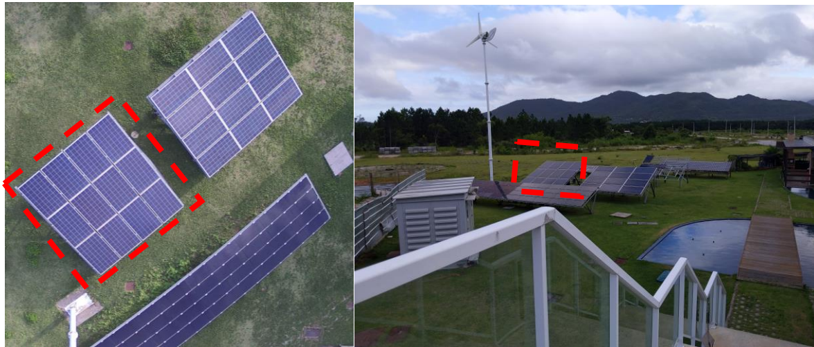
Figura 1. Imagens do sistema FV de 2 kW escolhido para a instalação da bateria no laboratório Fotovoltaica-UFSC. Fonte: elaborado pelos autores.
