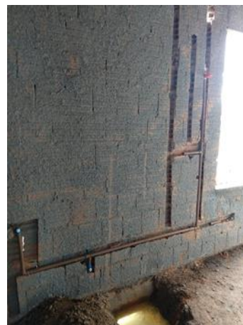
(b) Tubulação de água fria
