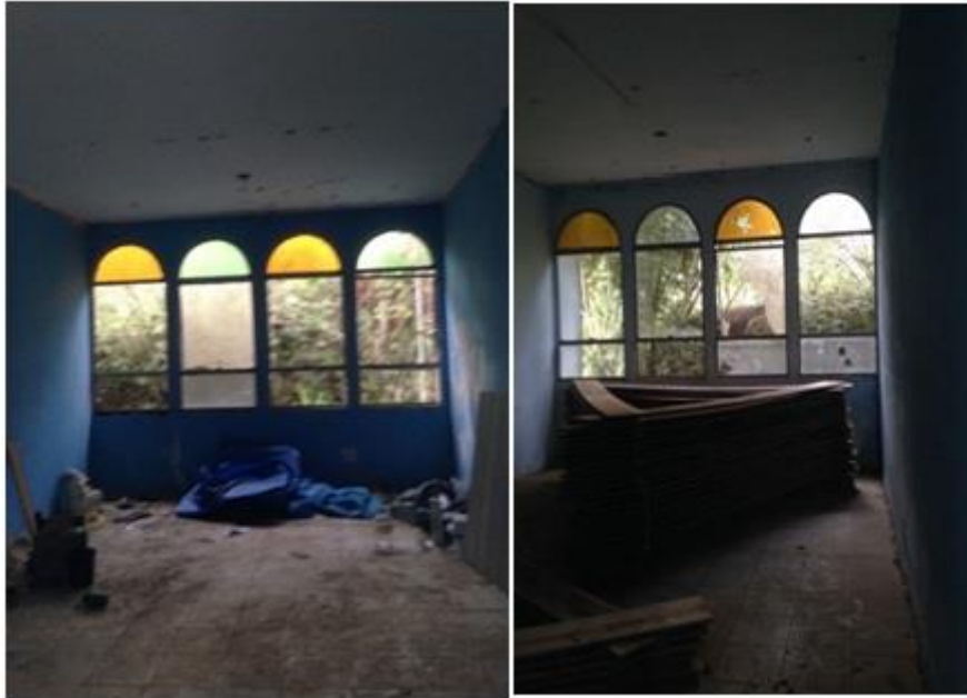
Figura 17 - Atual situação das salas de aula da Escola.
