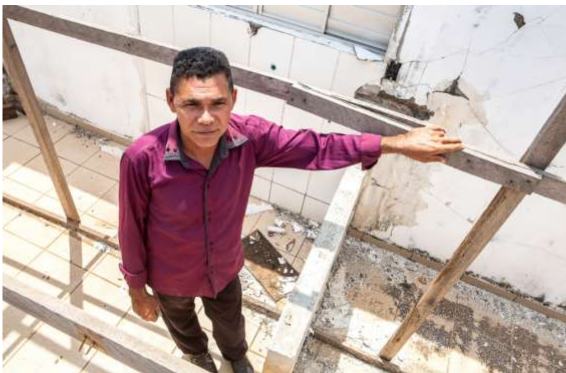
Figura 19: Josildo Carlos de Freitas mostra sua casa que ficou cheia de rachaduras e o teto desabou. Foto de Lilo Clareto/Amazônia Real (FONSECA, 2019).
