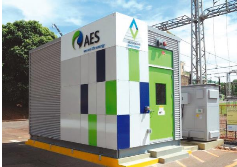
Figura 26 - Primeiro BESS conectado ao SIN instalado no Brasil
