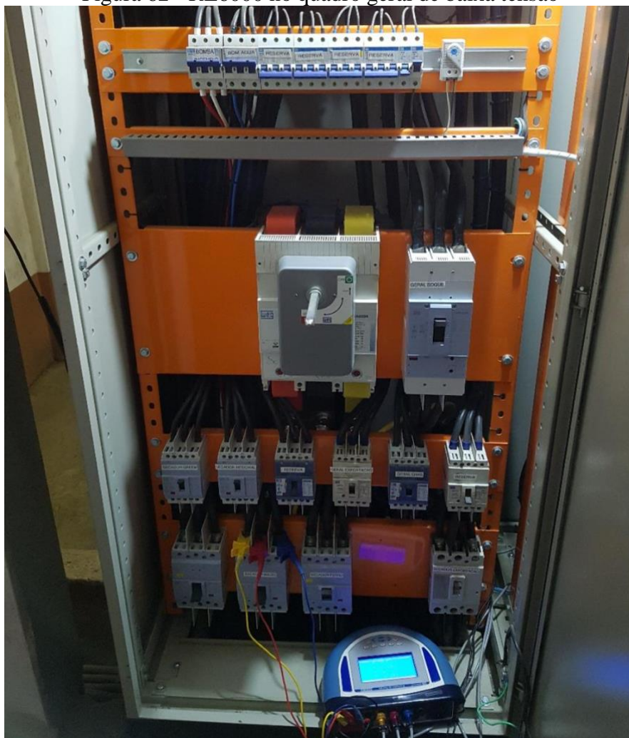
Figura 62 - RE6000 no quadro geral de baixa tensão
