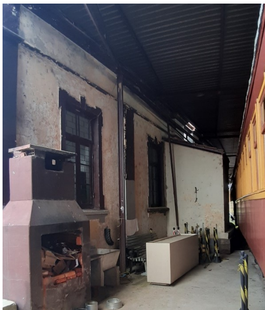
Figura 35 – Degradação da Estação Rio Negrinho.
