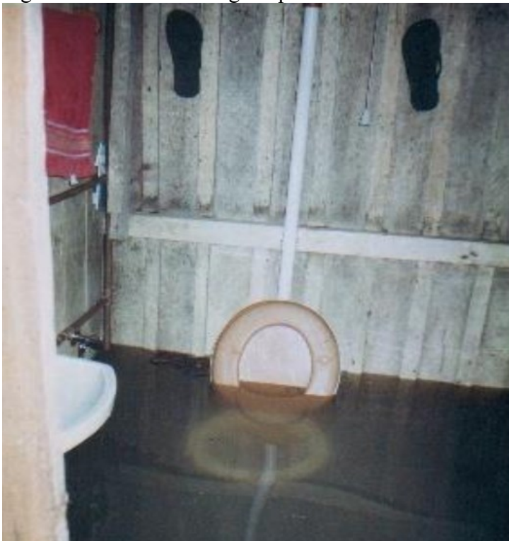
Figura 73 - Banheiro alagado pelo transbordamento do Canal do Galo na Bacia do Una.
