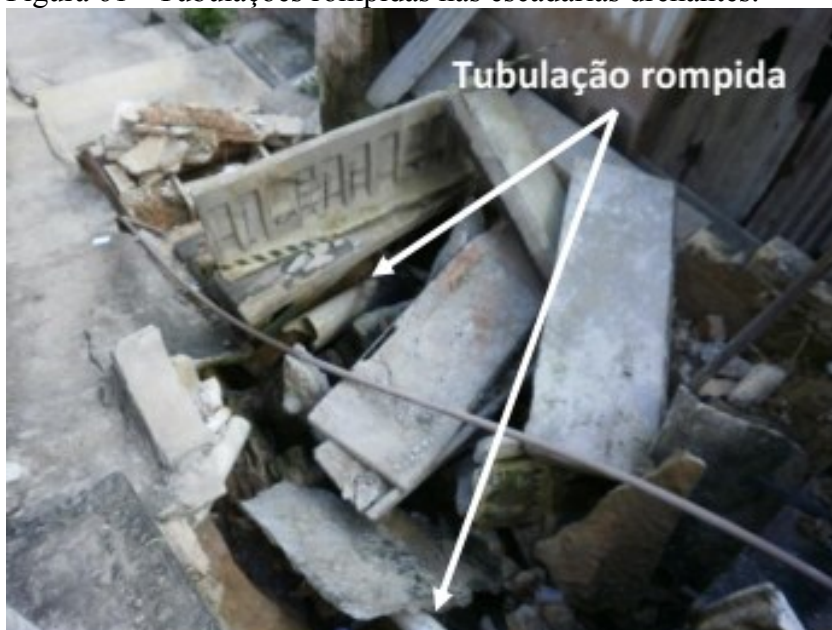
Figura 61 - Tubulações rompidas nas escadarias drenantes.
