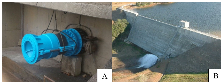
Figura 3 - Válvula dispersora da barragem rio São Bento (A), barragem principal com válvula dispersora aberta (B).
