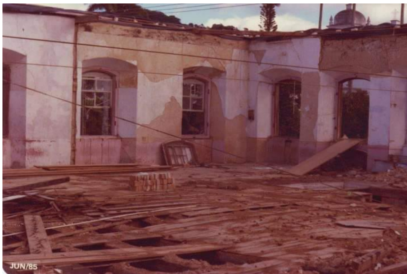
Figura 3 - Parte interna do Casarão Ferreira de Mello durante a reforma na década de 1980
