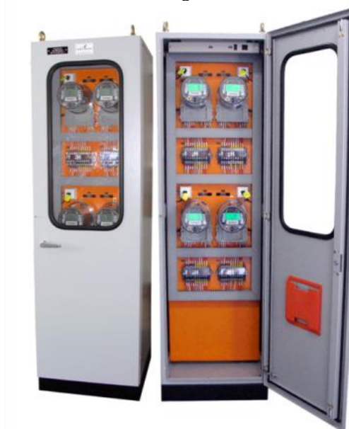
Figura 4 - Medidores de energia elétrica do SMF.
