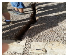
Figura 6: Rachadura terreno vizinho. Fonte: Autores (2017).
