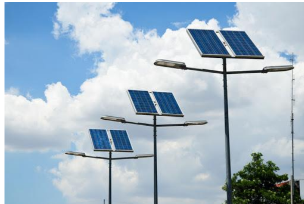
Figura 7: Posteamento com energia fotovoltaica e lâmpadas de LED instaladas. Fonte: https://bit.ly/3am8vAQ
