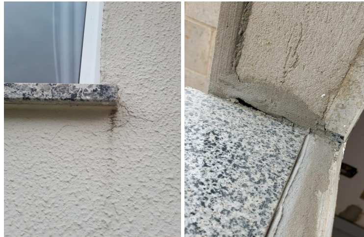
Figura 13: Fissuras na interface pedra pingadeira/reboco. Fonte: Acervo próprio das autoras.
