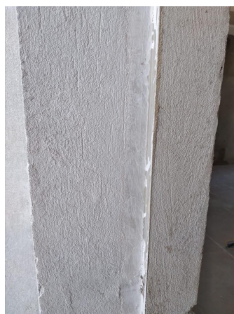
Figura 18: Contramarco instalado sem ranhura entre o mesmo e o revestimento (reboco). Fonte: Acervo próprio das autoras.
