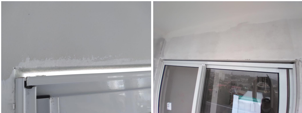
Figura 15: Folga excessiva no vão. Fonte: Acervo próprio das autoras.
