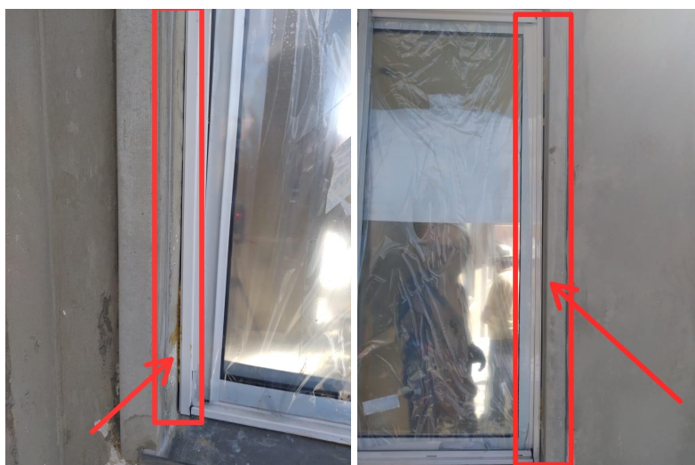
Figura 16: Ausência de vedação externa. Fonte: Acervo próprio das autoras.
