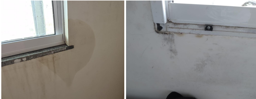
Figura 7: Infiltrações na interface interna do peitoril. Fonte: Acervo próprio das autoras.
