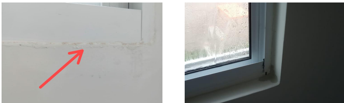
Figura 14: Infiltrações na interface esquadria/vão. Fonte: Acervo próprio da autoras.
