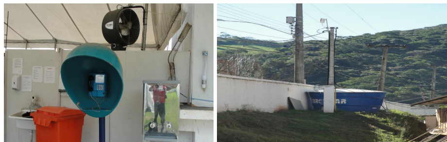
Figura 11: (a) Pontos de água e telefone. (b) Reservatório de água. Fonte: Costa (2015)
