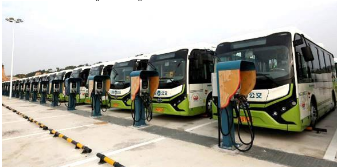
Figura 2 - Carregadores e ônibus elétricos em Shenzhen - China
