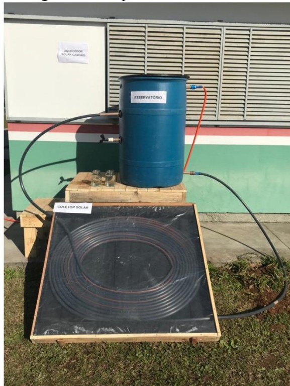
Figura 24 – Aquecedor Solar Caseiro
