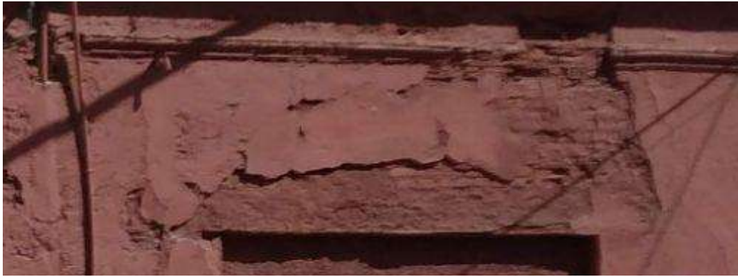
Figura 11. Detalhe da fachada do edifício da Rua Padre Roma que apresenta perda de material significativa, demonstrando processos e materiais da época de sua construção, que o validam como patrimônio cultural material. Fonte: da autora, 2021.
