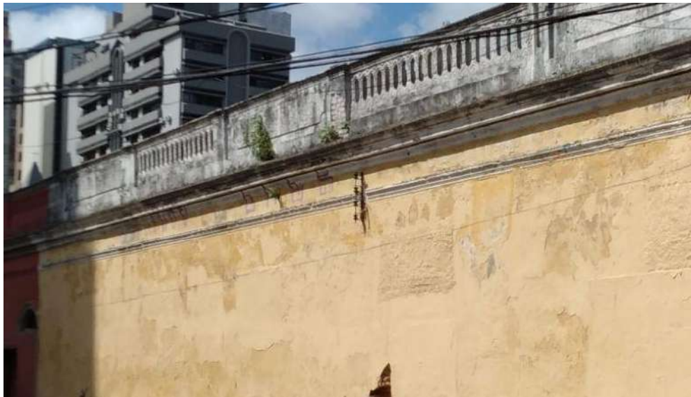
Figura 12. Detalhe da fachada do edifício da Rua Frederico Rolla que apresenta umidade e vegetação. Fonte: da autora, 2021.
