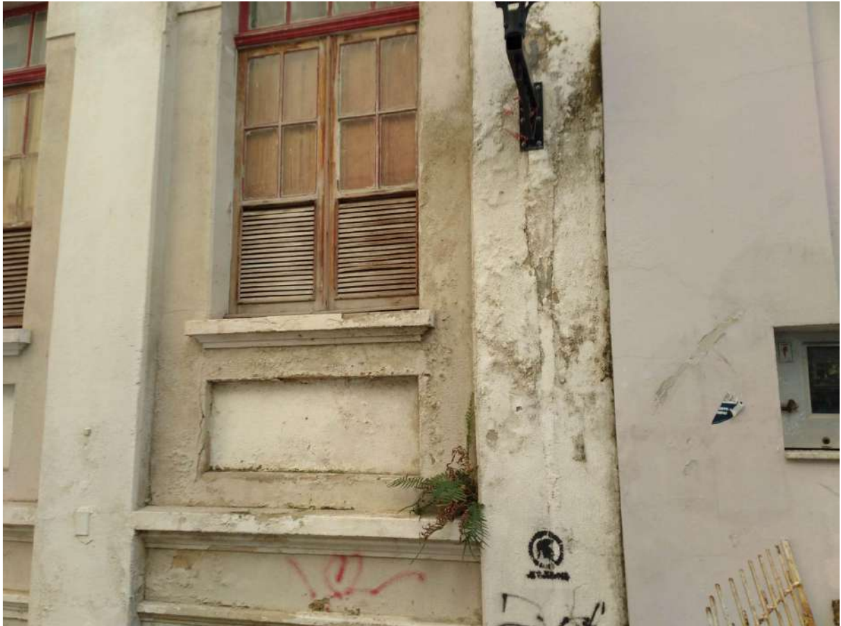
Figura 04. Detalhe da fachada do edifício da Rua Trajano que apresenta umidade e presença de vegetação.
