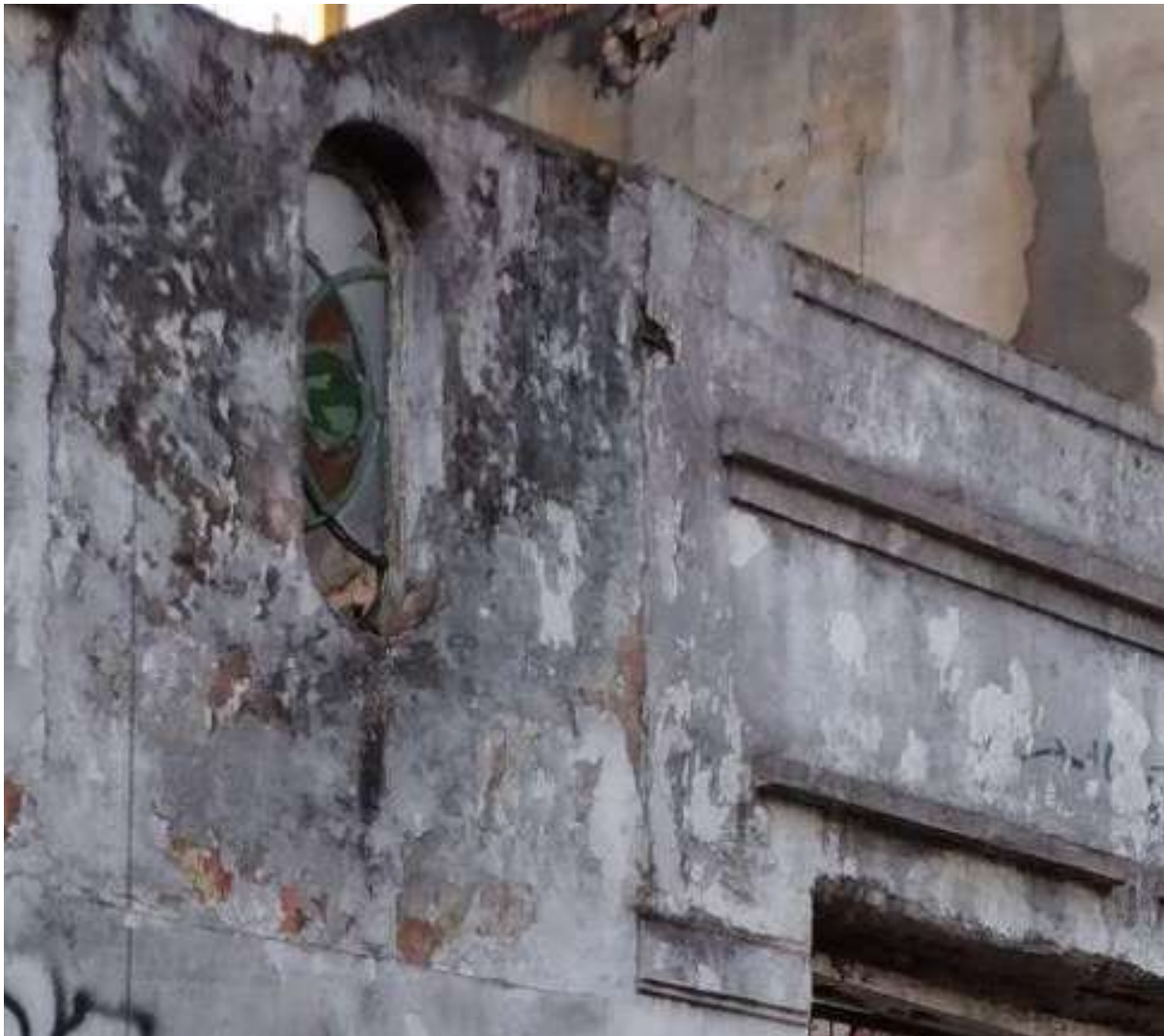
Figura 05. Detalhe da fachada do edifício da Rua Vidal Ramos que apresenta perda de material e sujidade. Fonte: da autora, 2021.
