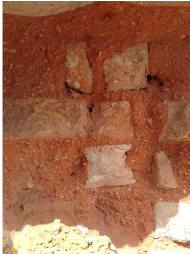
Figura 10. Detalhe da fachada do edifício da Rua Frederico Rolla que apresenta perda de material significativa, demonstrando processos e materiais da época de sua construção, que o validam como patrimônio cultural material. Fonte: da autora, 2021.
