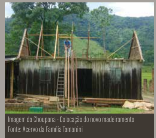
Imagem da Choupana em processo de restauração do telhado Fonte: Acervo da Família Tamanini
