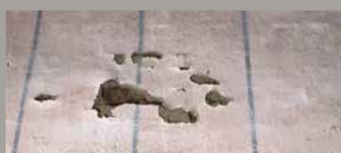
Dano na parede da Sala de Estar Fonte: Arquivo Pessoal
