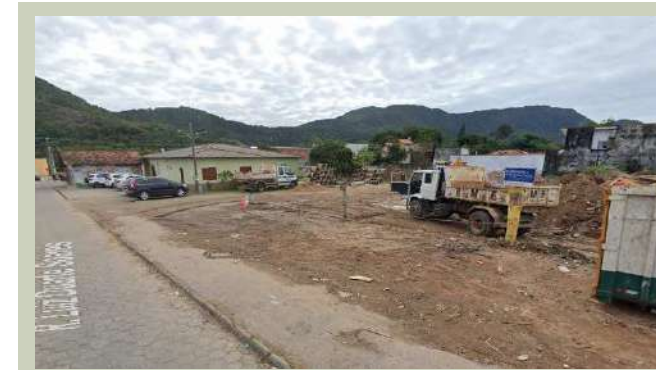
Figura 73: Espaço usado para colocação de entulho, mate- riais e maquinário, com AMORV no fundo em verde.
