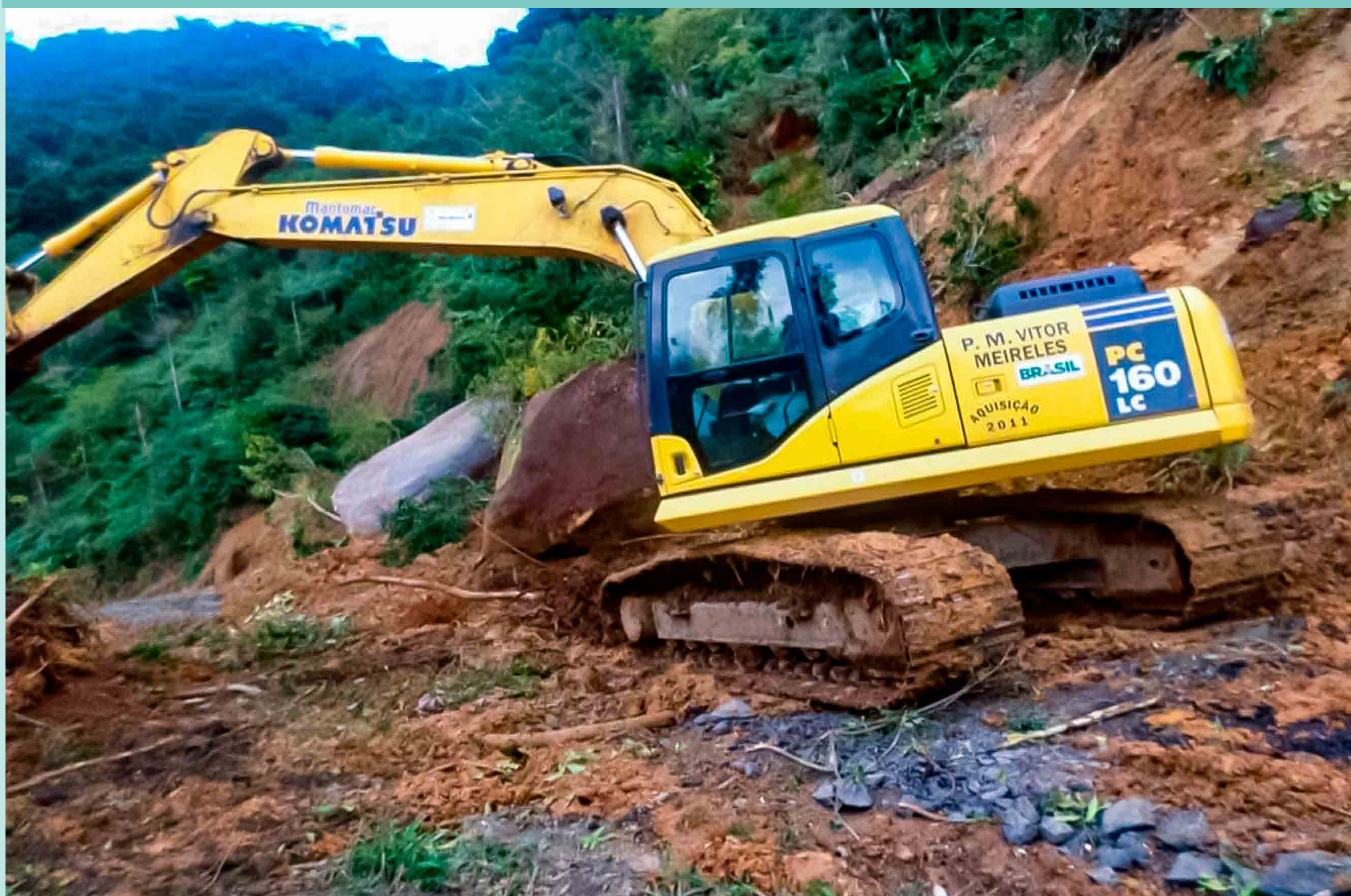
Figura 3: Deslizamento de terra na estrada geral durante o período de cheia do rio. Aldeia Figueirinha, 2014. Fonte: acervo pessoal.
