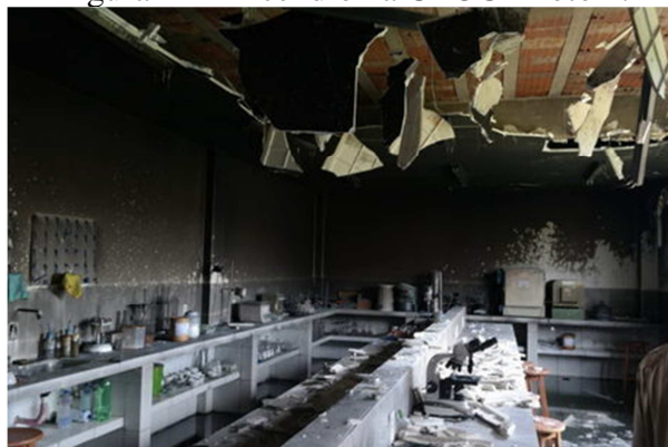
Figura 14 – Incêndio na UFCG – foto 2.
