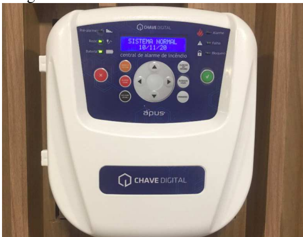
Figura 25 – Central de alarme de incêndio.
