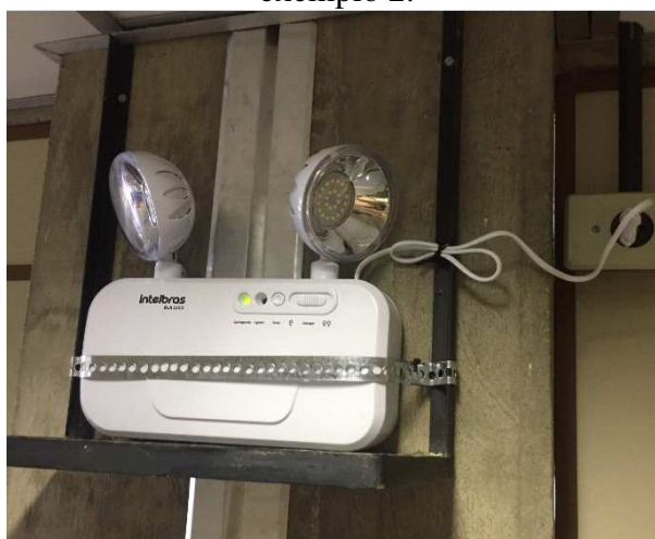
Figura 24 – Luminária de emergência – exemplo 2.
