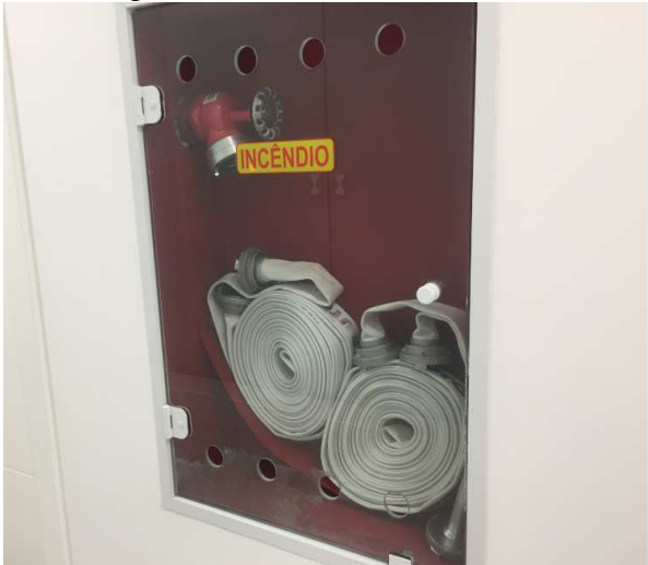
Figura 21 – Sistema de hidrante.
