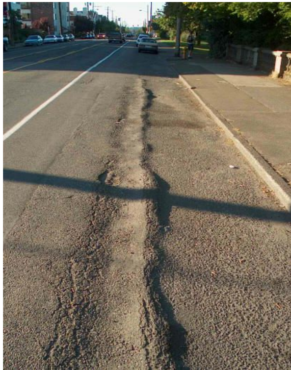
Figura 3.5 - Afundamento na trilha de roda.
