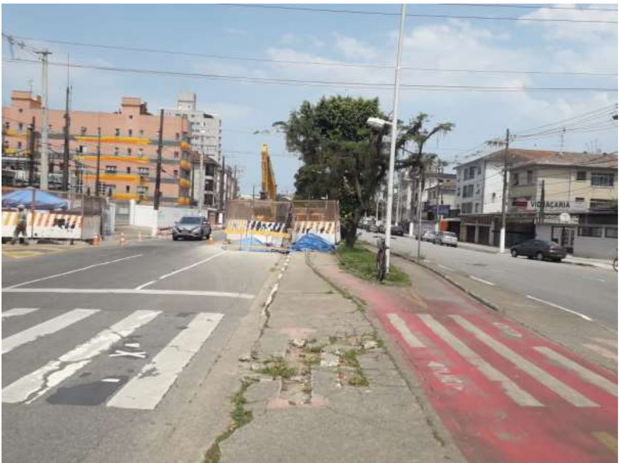
Figura 10 – Canteiro de obras na localizado na Avenida Afonso Pena e imagem parcial do canteiro da Rua João de Barros
