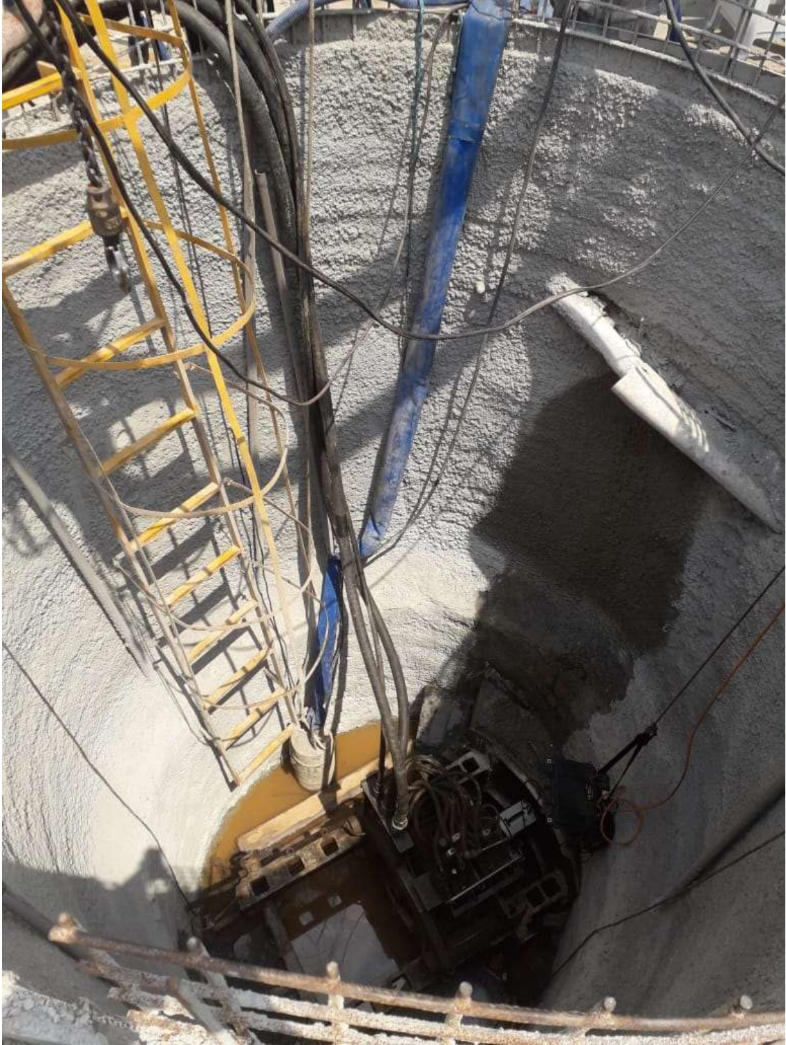
Figura 2 – Poço de acesso sendo escavado por um mini-shield em direção ao poço de recepção
