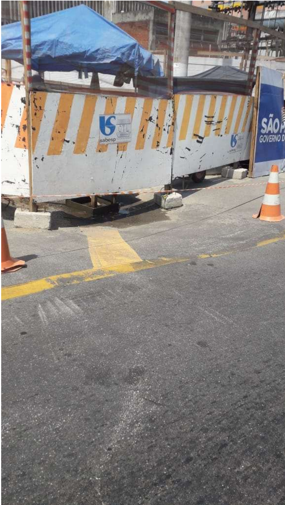
Figura 8 – Trecho sob infiltração subterrânea devido à tubulação defasada
