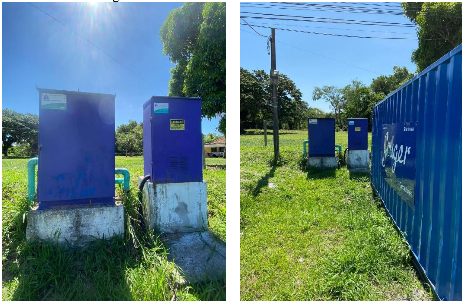
Figura 10 - Booster localizado na SC-401.
