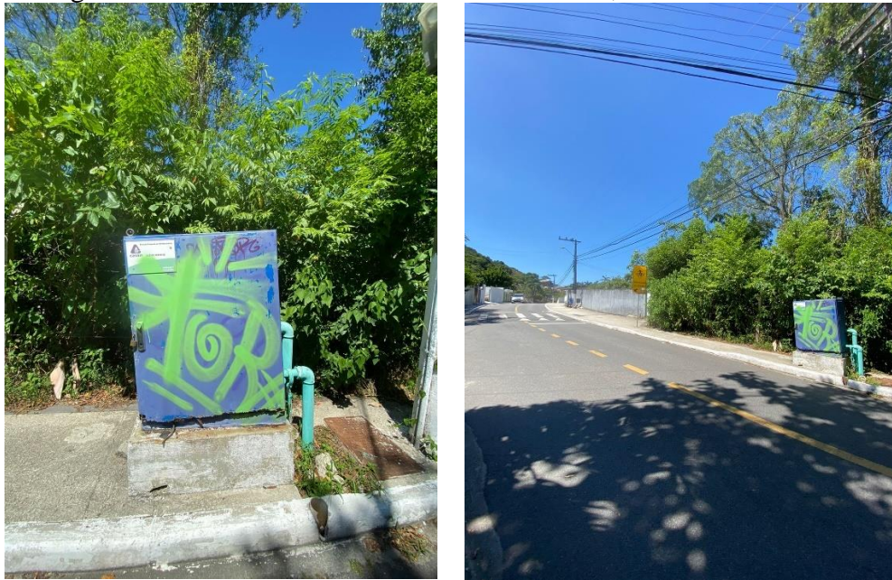
Figura 11 - Booster localizado na Rua Isid Dutra, em frente ao nº 280.
