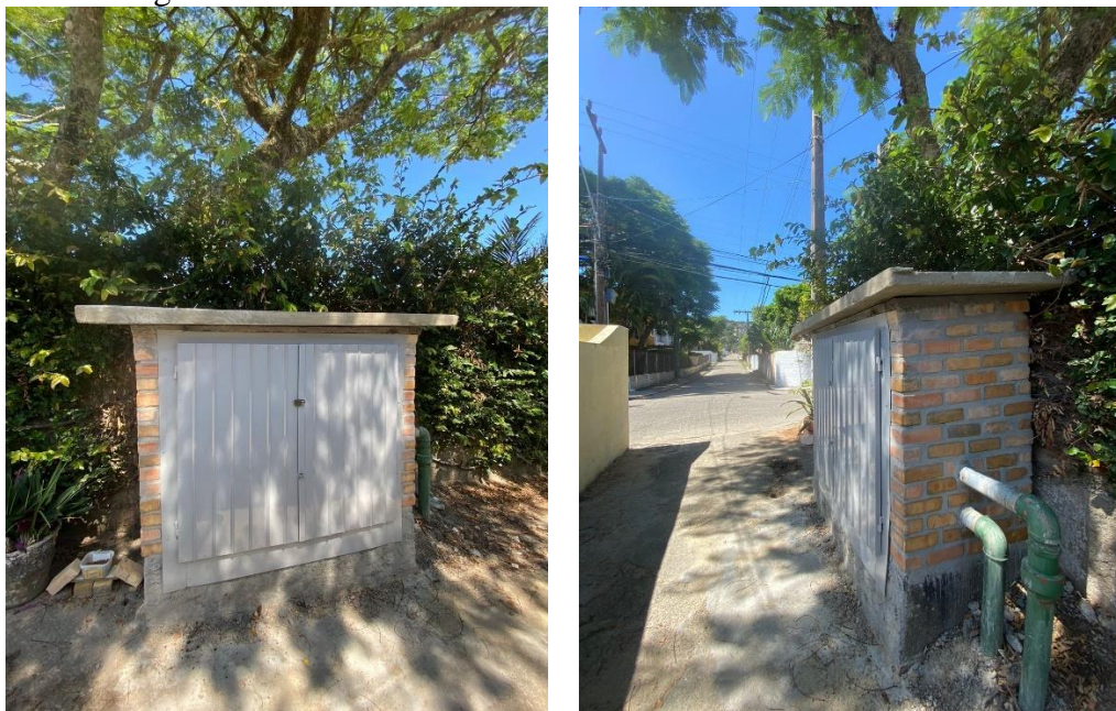
Figura 13 - Booster localizado na Rod. Rafael da Rocha Pires.
