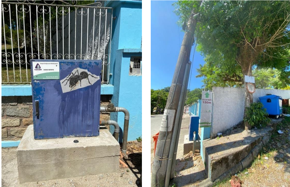
Figura 14 - Booster localizado na entrada da Rua das Ostras.
