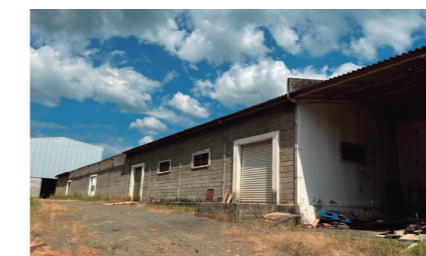
05 - Edifício sem função definida. Atualmente em uso e abandonado, inclusive sem telhamento.
