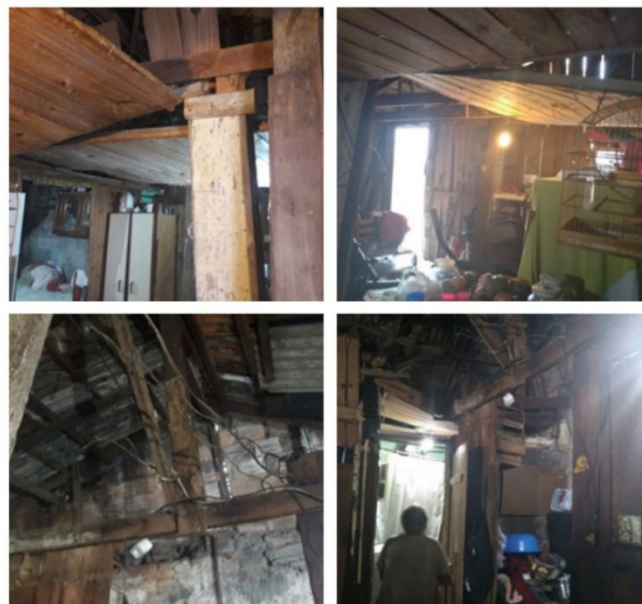
Figura 2- Condição de precariedade habitacional
